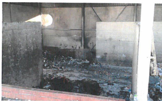
Vue intérieure du centre de tri après l'incendie
